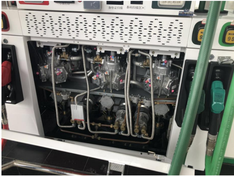
图 3-3 油气回收装置
