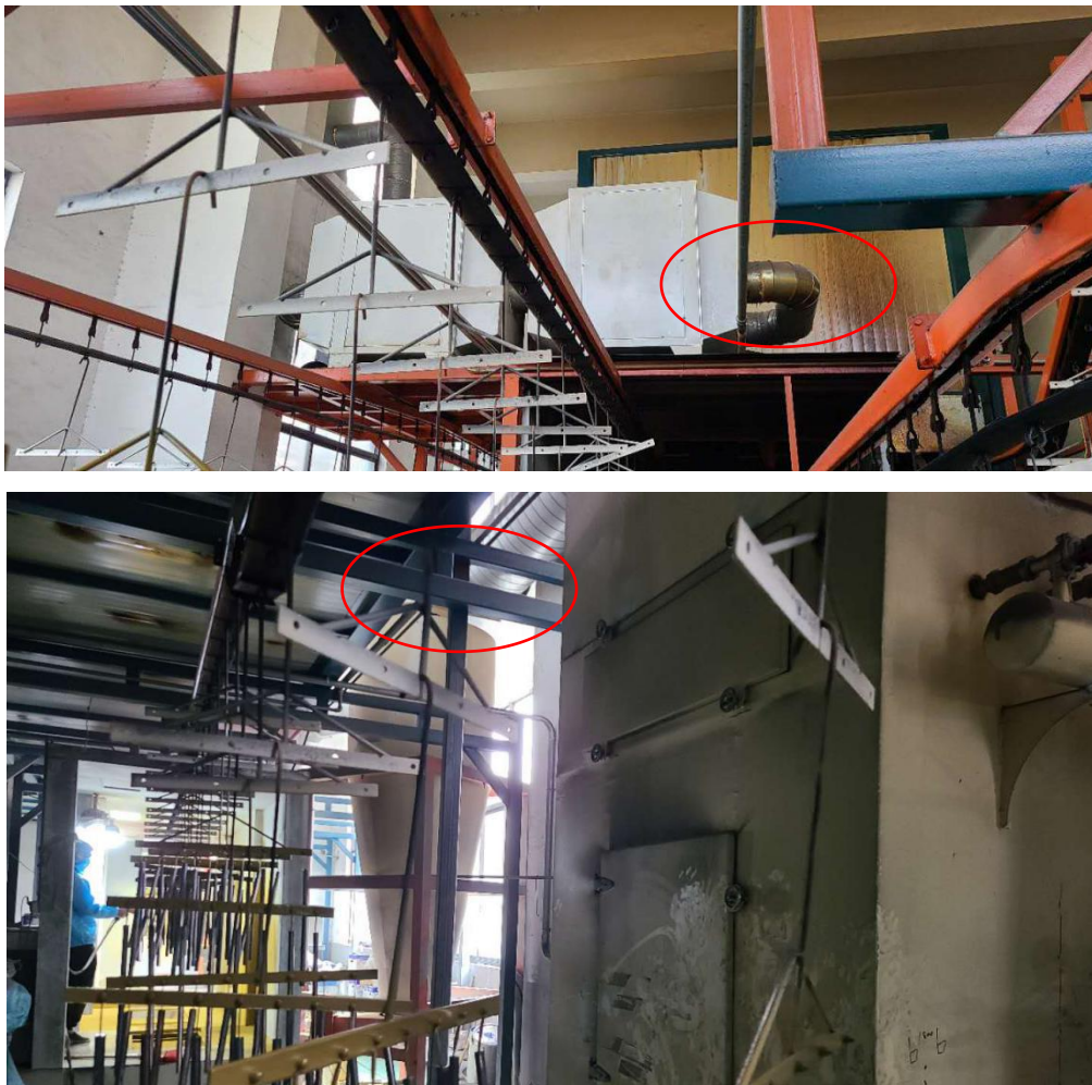
图 7-1 废气处理设施现场照片（进口段的管道长度短）
