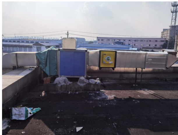
图 7-3 食堂油烟净化器进出口
