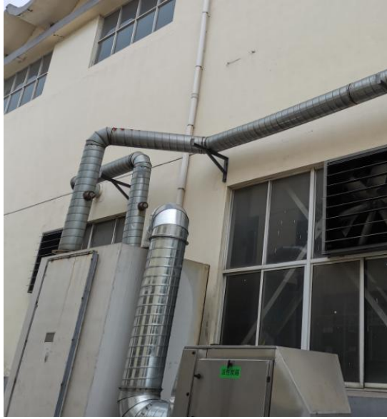
1#二级活性炭废气处理措施
