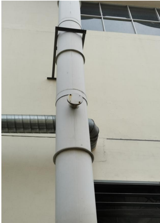
1#排气筒出口检测口
