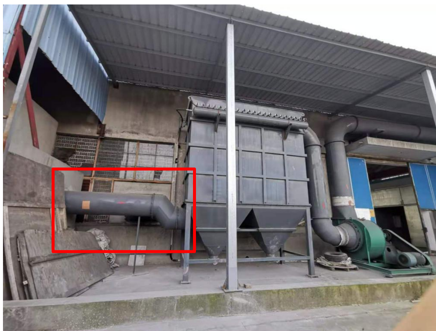
1#布袋除尘器入口处照片
