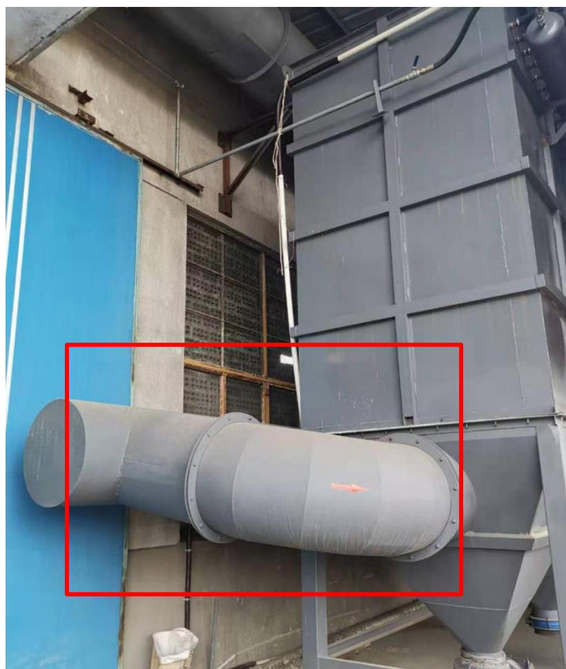
2#布袋除尘器入口处照片
