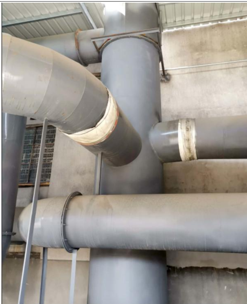
布袋除尘器出口处照片
