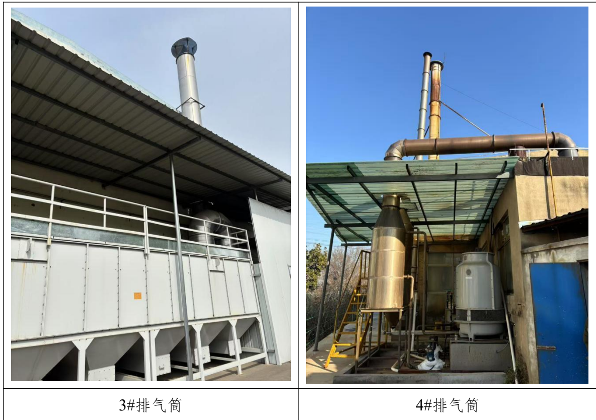
图 3-1 废气防治措施现场照片
