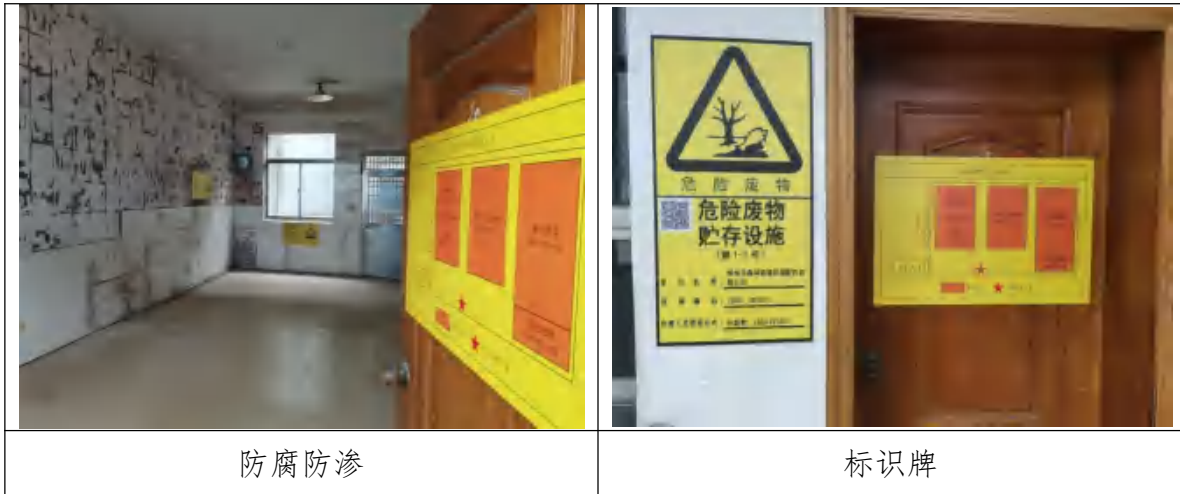
图 3-5 危废仓库现场照片
